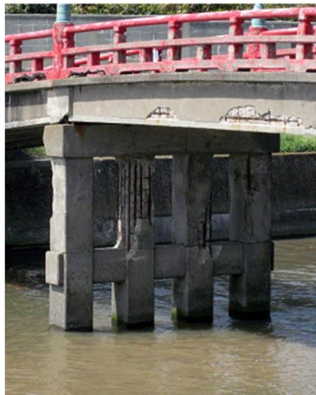
橋脚も橋桁もかなりの劣化具合
