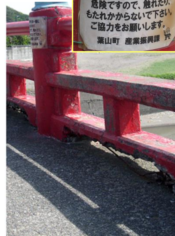
欄干も腐食が進行している模様
